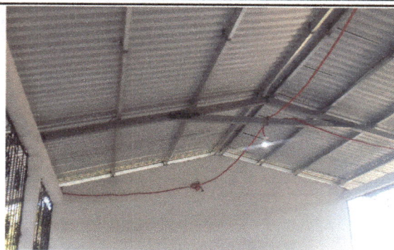
Foto 2: TECHO INSTALADO AL 100 POR CIENTO CON ENERGÍA ELECTRICA.
